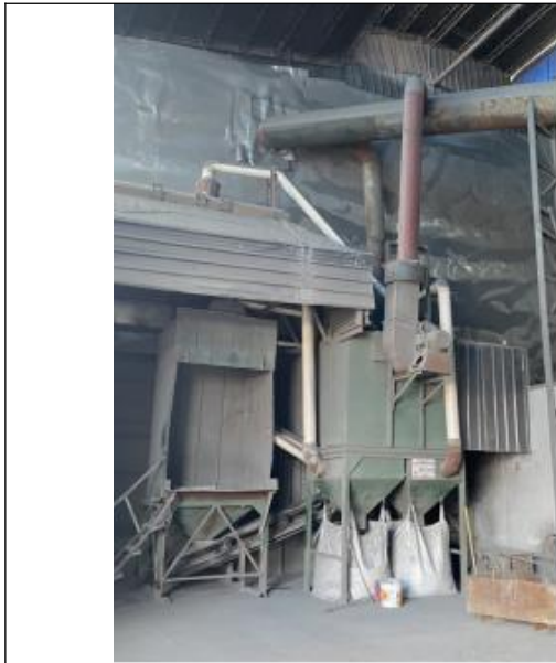
图 1 脉冲布袋除尘器（处理投料粉尘）
